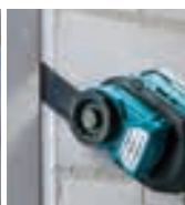
Corte de masilla de ventanas, silicona.
